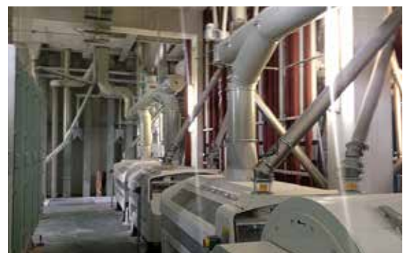
Ableitfähige EPDM-Bördeldichtringe beugen der Gefahr einer Mehlstaubexplosion vor.
