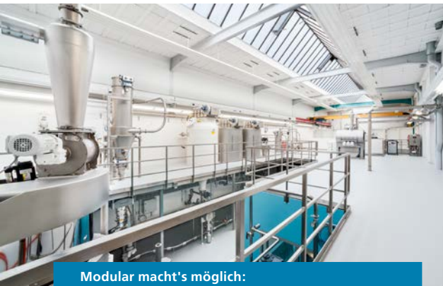
Modular macht's möglich: alle Technologien auf wenig Raum.
