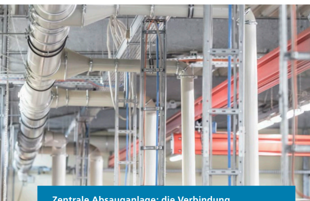
Zentrale Absauganlage: die Verbindung zwischen Maschine und Filter
